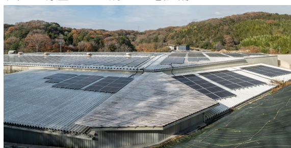
■ 本社工場屋上の太陽光発電設備
