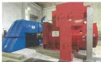
相沼内発電所
