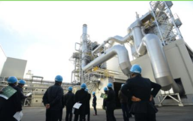
2015年から順調に稼働している 真庭バイオマス発電所
