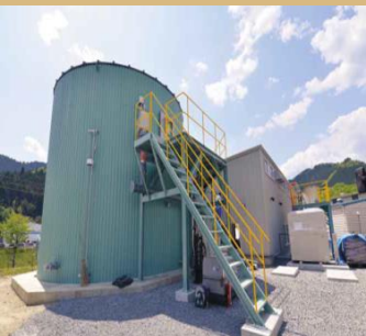
メタン発酵実証プラント
